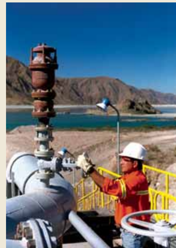
-Rampas de bombas para recuperación de aguas del dique de colas. -Pablo Saguir, supervisor de dique, operando válvulas de la rampa de bombeo.
