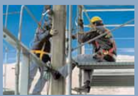
-Trabajos en altura, con la indumentaria correspondiente para desempeñarse en un ambiente seguro.
